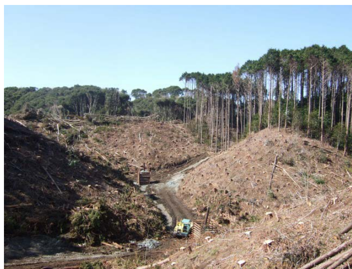
南豆の伐採現場 と 大雨の日の民家の近くの泥流
