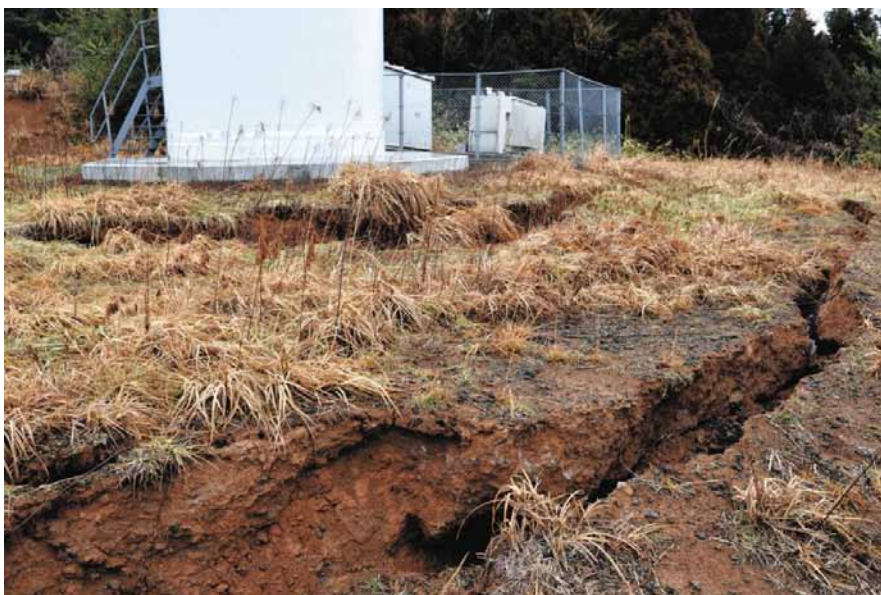
地割れした風力発電の基礎部分＝2月20日、石川県七尾市で（大野沙羅撮影）
