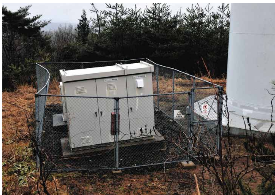
地震で傾いた風力発電の基礎近くにある変電設備＝石川県七尾市で
